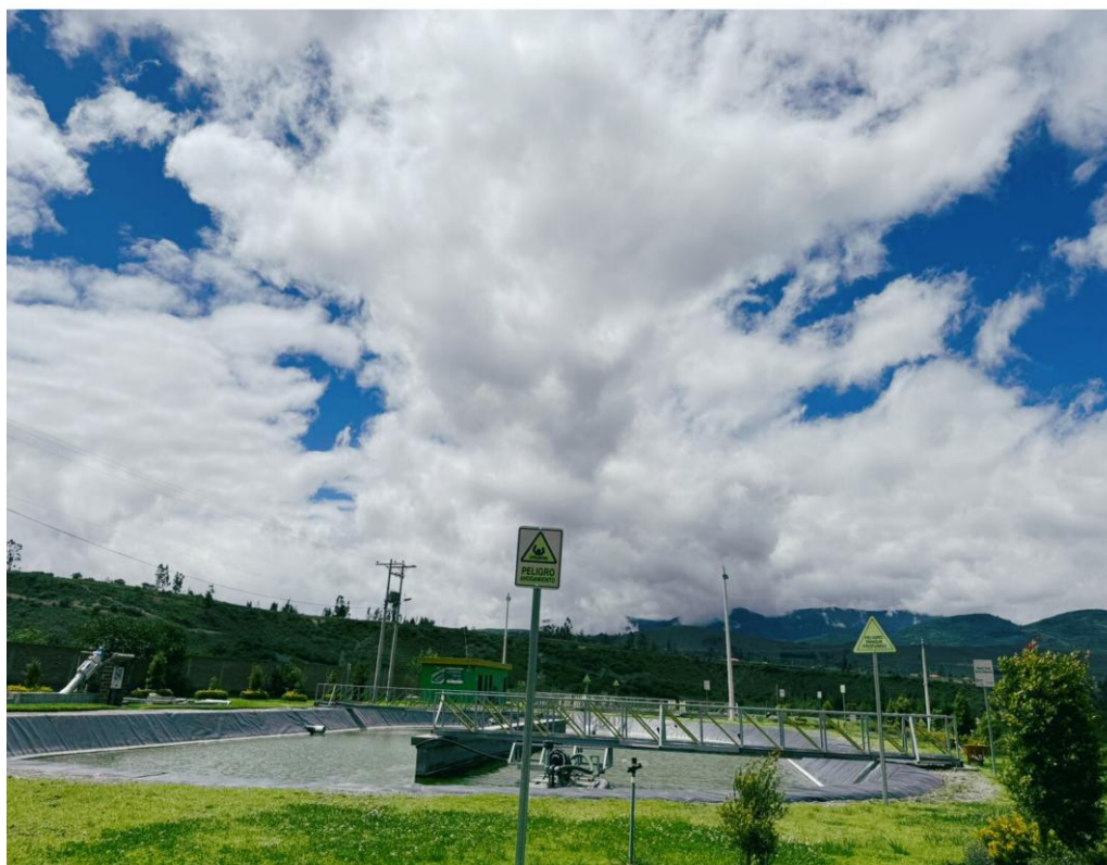
Fotografía 40 Planta de tratamiento
